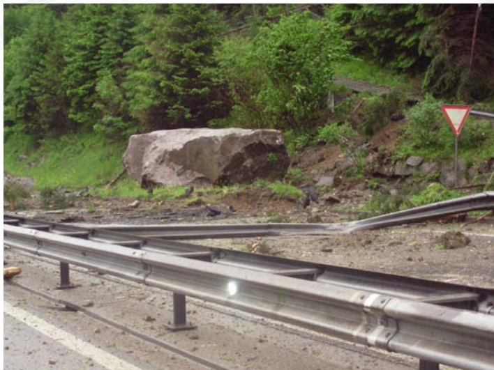
Am 31. Mai 2006 etwa um 06.45 Uhr stürzte ein Fels auf die Autobahn A2 in Gurtnellen.
