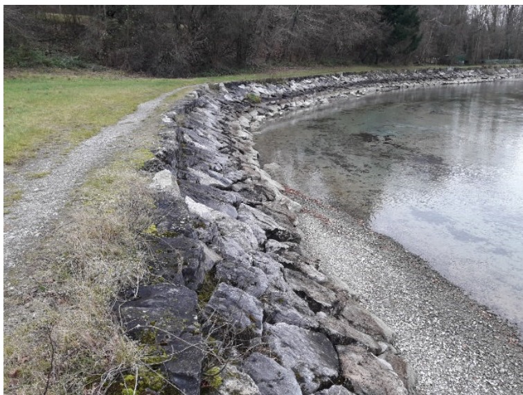
Abbildung 4-7: Blocksatz verfugt, im Bereich der Bucht und der Campingplätze Ziegelhütte und Läui mit einem auf der Böschungsoberkante verlaufenden Wanderweg
