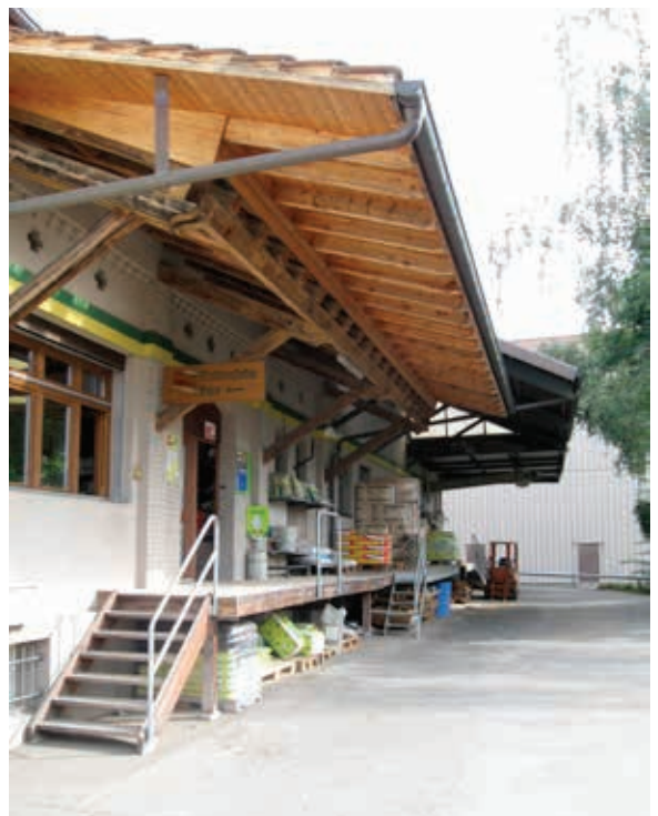
Ein Güterumschlagplatz muss überdacht, befestigt und abflusslos sein. Zusätzlich muss jederzeit Bindemittel bereit stehen.
