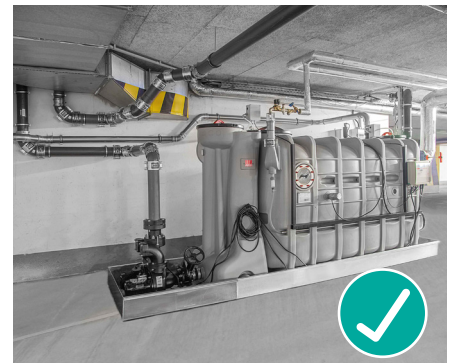
Freistehende Anlagen mit gutem Zugang für Überwachung und Wartung entsprechen dem Stand der Technik.
