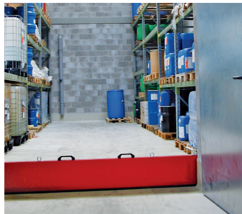
Leckage-/Löschwasserrückhalt (Bildquelle: Amt für Umwelt, Kt. TG)
