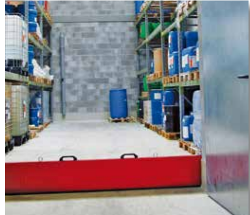
Leckage-/Löschwasserrückhalt (Bildquelle: Amt für Umwelt, Kt. TG)
